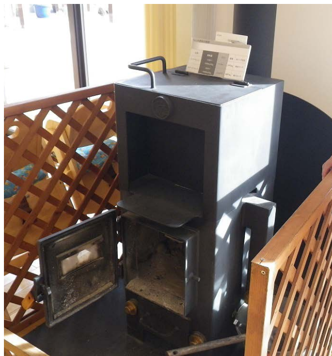
木質ペレットボイラーの例(岩手県葛巻町)
