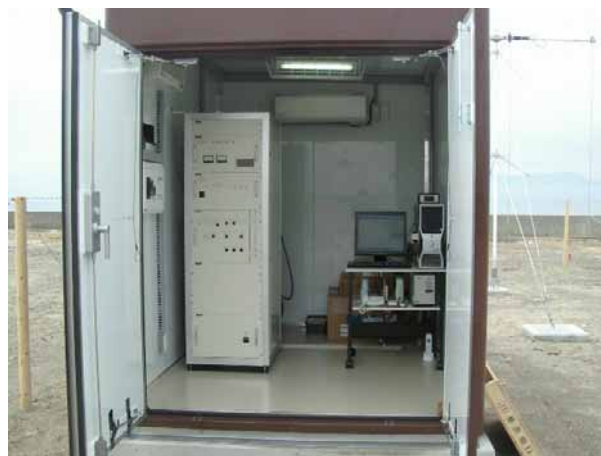
図4 レーダー観測局の局舎内
