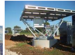
イタリアSan Donaci発電所
