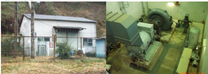
富士緒井路発電所
